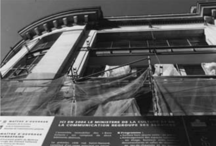
Le démarrage du chantier des Bons Enfants est entré dans une phase opérationnelle au début du printemps 2002, vue côté rue Saint-Honoré, à Paris
