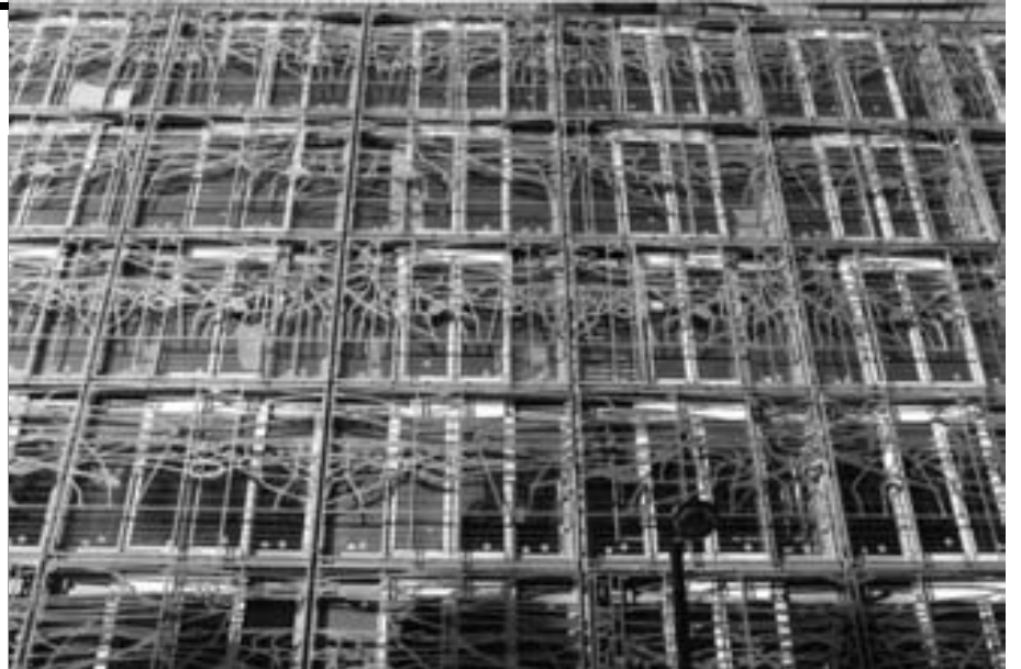
Chantiers des Bons Enfants, façade de l'immeuble côté rue Croix des Petits Champs, à Paris
